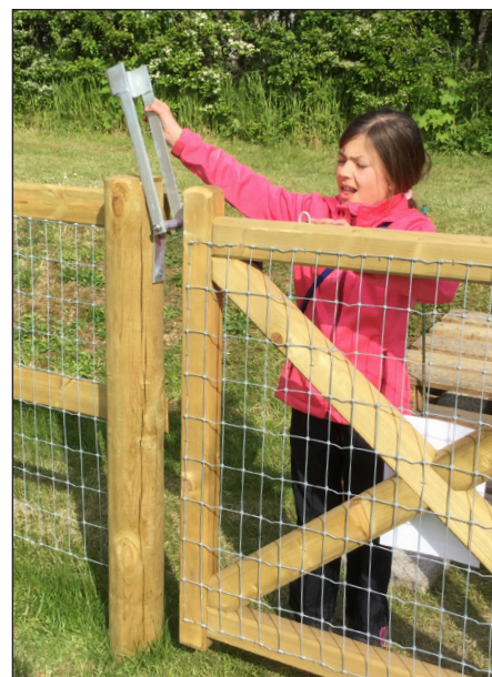
De Country Estate poorten worden gemonteerd met gaas dat bij de omheining past. Het hang- en sluitwerk wordt aangepast aan de gekozen hekken.
